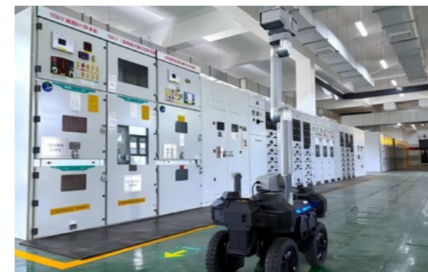
▶ 福建海上風電項目高清紅外成像儀的輪式巡檢機械人
