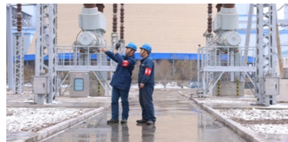
▶ 托克托發電公司以常態化巡檢保障電力可靠供應
