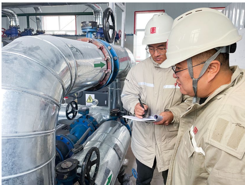
清洁能源供暖项目日常巡检
